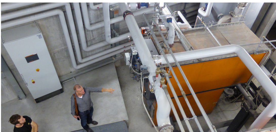
Pregled ogrevanja na lesne sekance
